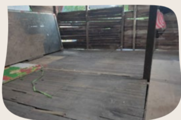
修葺前的破旧地板，承受不了多人重量。
